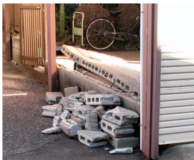
何らかの拍子で倒壊や落下し、ケガをする可能性がある。
